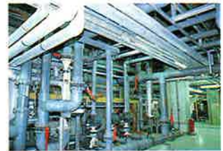
バックヤードにはパイプが縦横に走っている。
