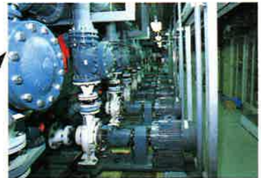
水族館の心臓といえるポンプは、水を循環させるためにはなくてはならないもの。
